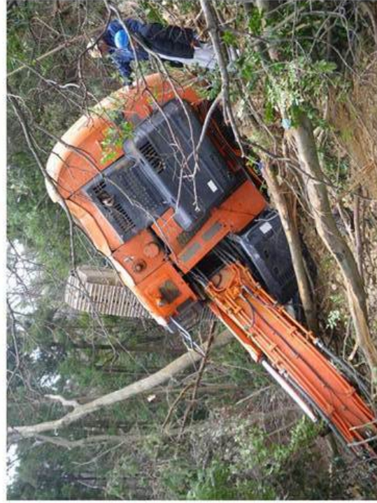
② 転落した油圧ショベルの状況
