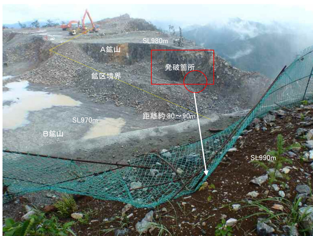
発破箇所及び破損した転石防止柵
