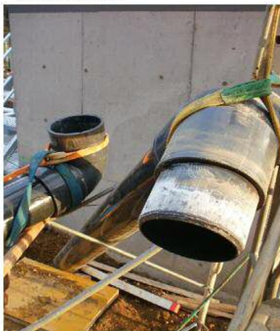
<脱落配管拡大写真>
