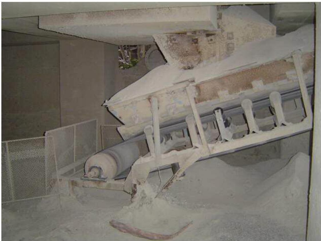
災害発生箇所(第二工場碎鉱場下部プラントNo.80ベルトコンベアテールエンド部)
