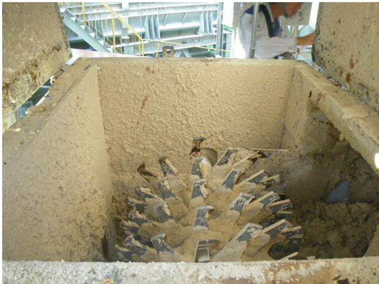
ケーキ解砕機内部の状況(右側が上流側でケーキが詰まった箇所)
