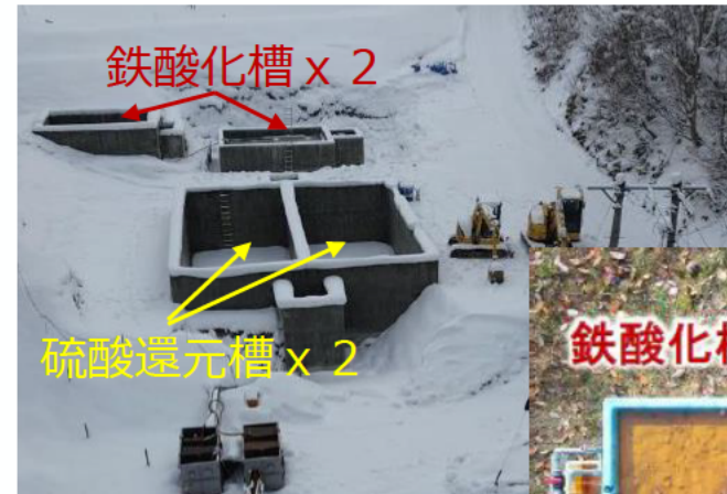
A鉱山のPT実証設備の設置状況 令和8年2月
