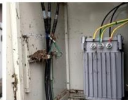
キュービクル内浸水(豪雨・洪水)
