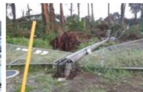
構内柱倒壊(暴風・倒木)
