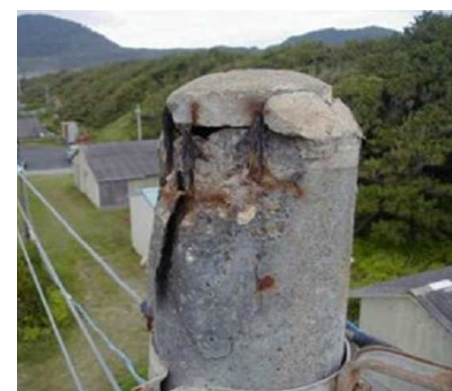
塩害による頂部の剥離
