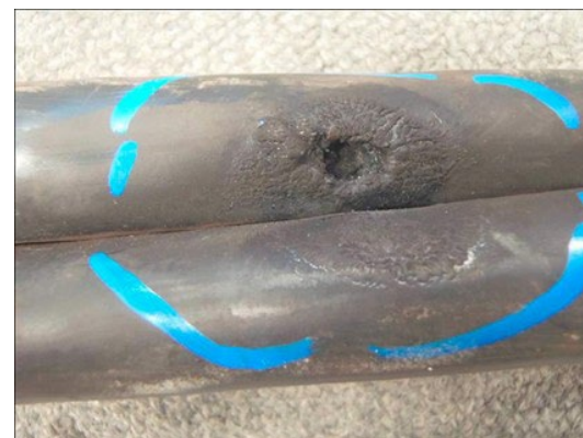
水トリ－による絶縁破壊事例
