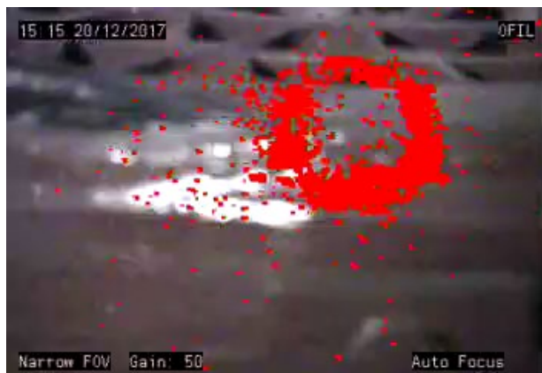
故障モールド変圧器の部分放電
