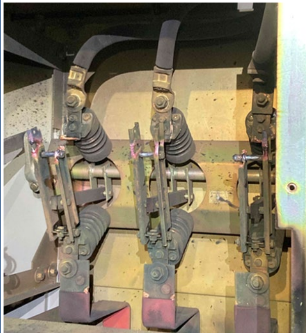
破損した断路器
