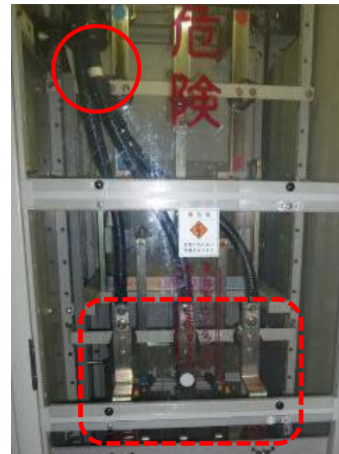
充電部露出箇所
