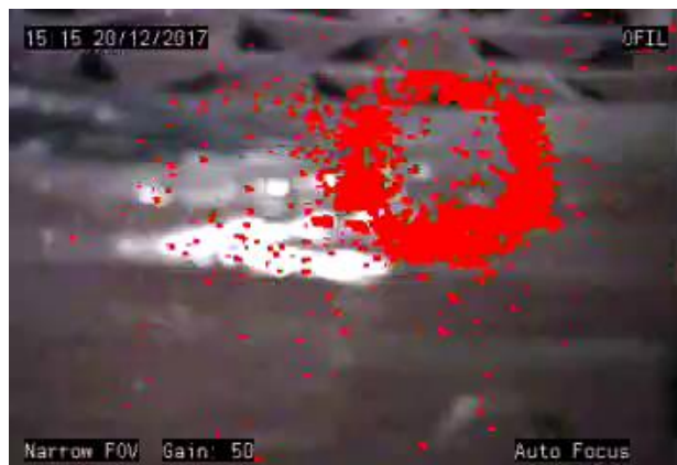
故障モールド変圧器の部分放電
