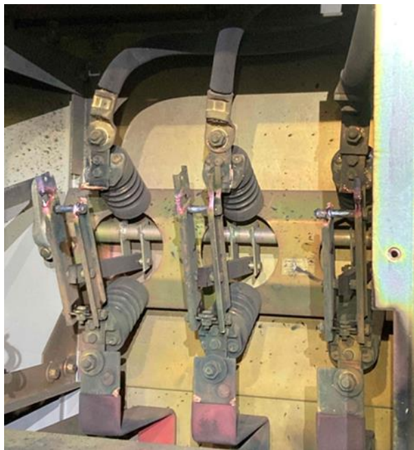
破損した断路器
