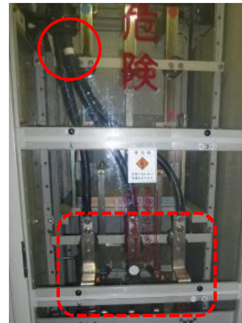
充電部露出箇所
