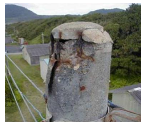
塩害による頂部の剥離
