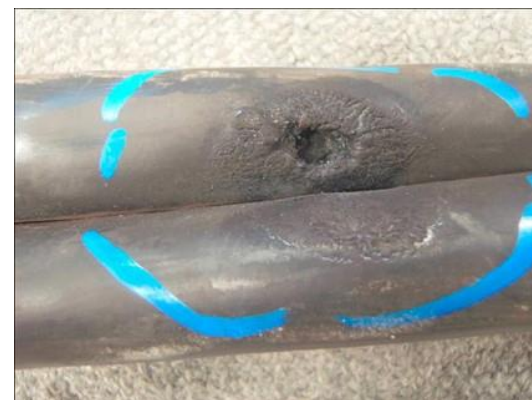
水トリ－による絶縁破壊事例
