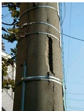
合わせ目の劣化
