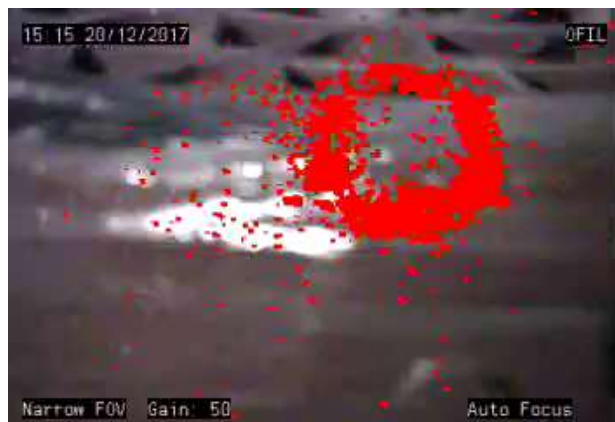
故障モード変圧器の部分放電
