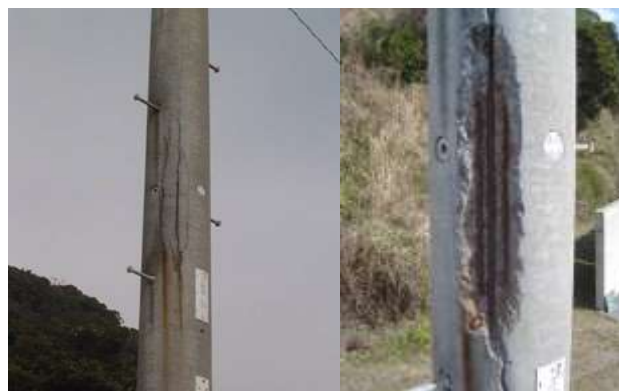
塩害による縦ひびと剥離
