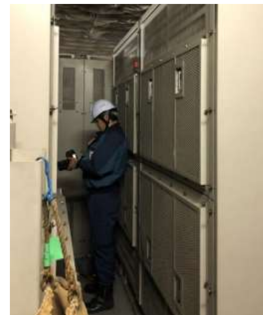
モード変圧器診断状況
