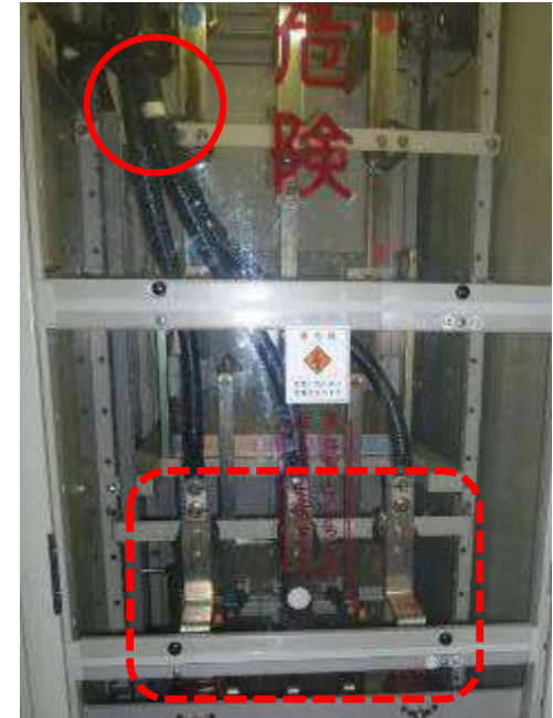
充電部露出箇所
