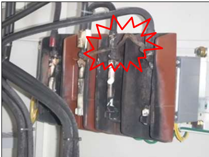
キュービクル内に蛇が侵入し ヒューズ取り付け箇所で短絡
