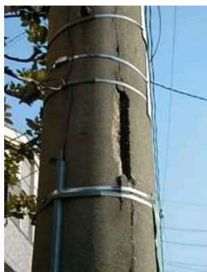
合わせ目の劣化
