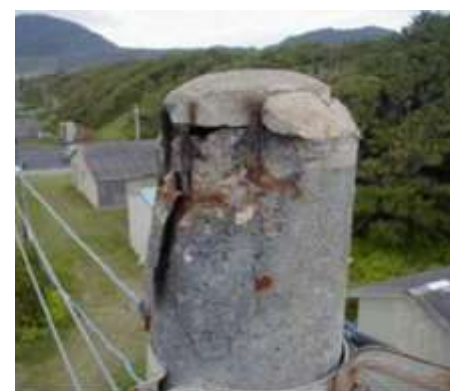
塩害による頂部の剥離
