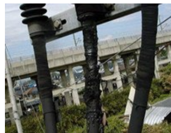
ケーブルヘッド焼損
