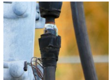
ケーブル内部露出
