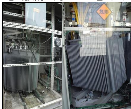
変圧器の移動・転倒
