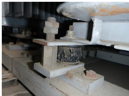
防振ゴム (劣化)
