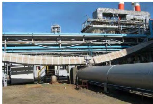
ケーブルダクトが架台から脱落
