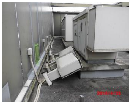
分電盤の転倒 (九州電気管理技術者協会 熊本地震の受変電設備等の被害写真より)
