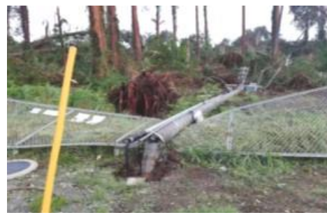
構内柱倒壊 (暴風・倒木)
