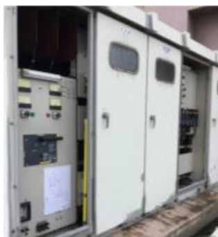
キュービクル扉破損 (暴風)
