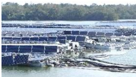
太陽光発電設備崩壊 (暴風)
